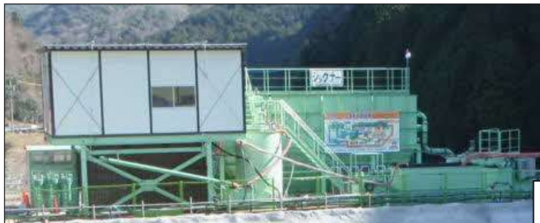
トンネル排水の処理設備
