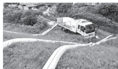
排水ポンプ車のイメージ (R2.7豪雨災害)
