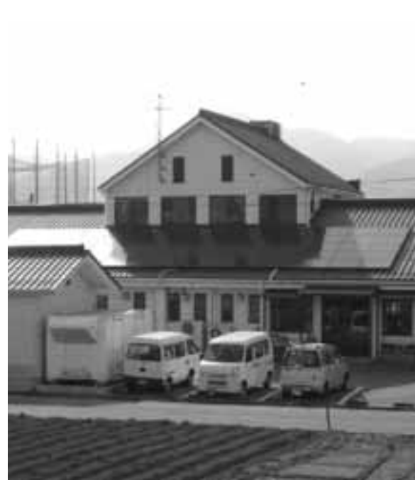
交流センター屋根に取付けられた太陽光発電パネル
