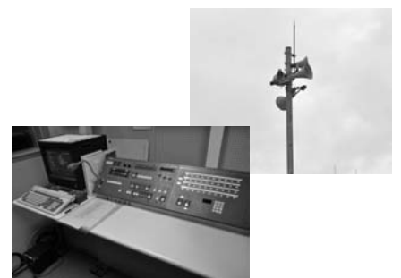
整備前の同報系防災無線
