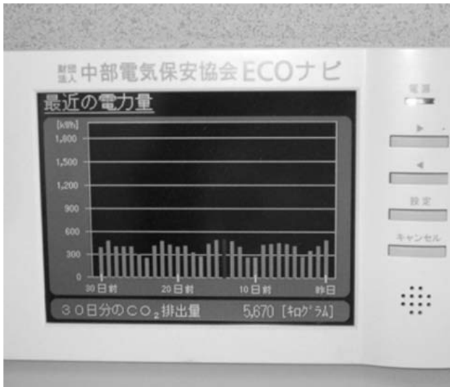
庁舎内に設置された電力監視装置
