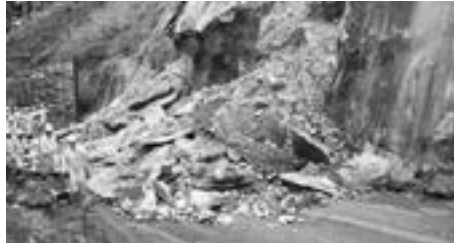
崩落被害の林道
